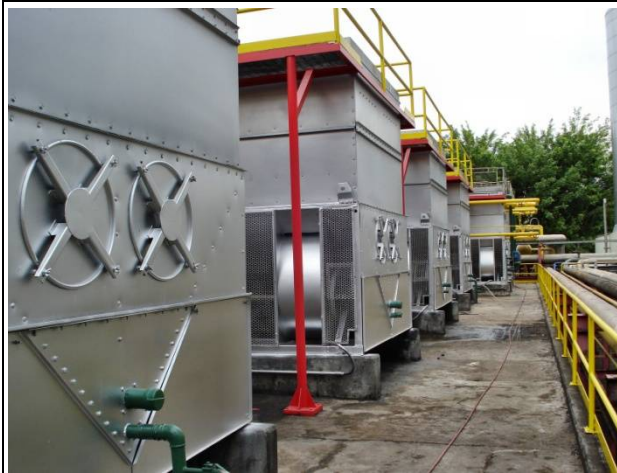
Cjto. de 5 condensadores VLC500 após reforma
